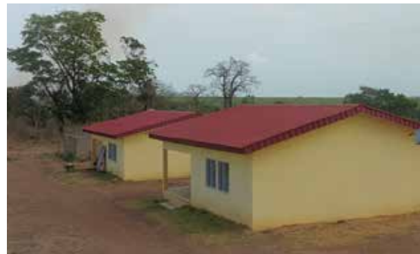
Réhabilitations de logements à Borotou et à Zuénoula au profit des employés.
